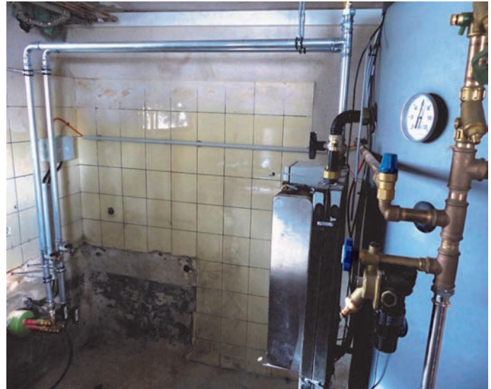
So sieht ein Hausanschluss der Fernwärmeversorgung Kastl aus, links kommt die Heißwasserleitung aus der Wand und führt rechts in den Wärmetauscher und von dort in den Pufferspeicher mit 2 Heizkreisen
