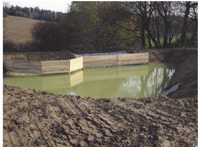
Das angelegte Regenrückhaltebecken
